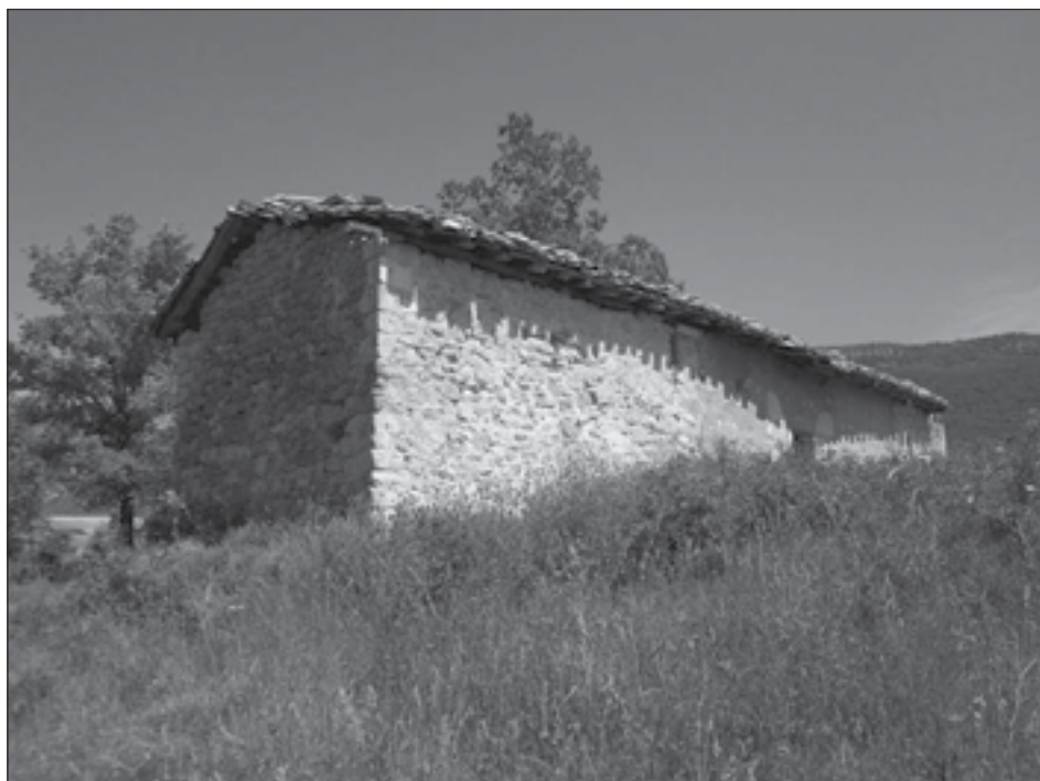
Figura 1. Vista actual de las paredes sur y este de la ermita.
